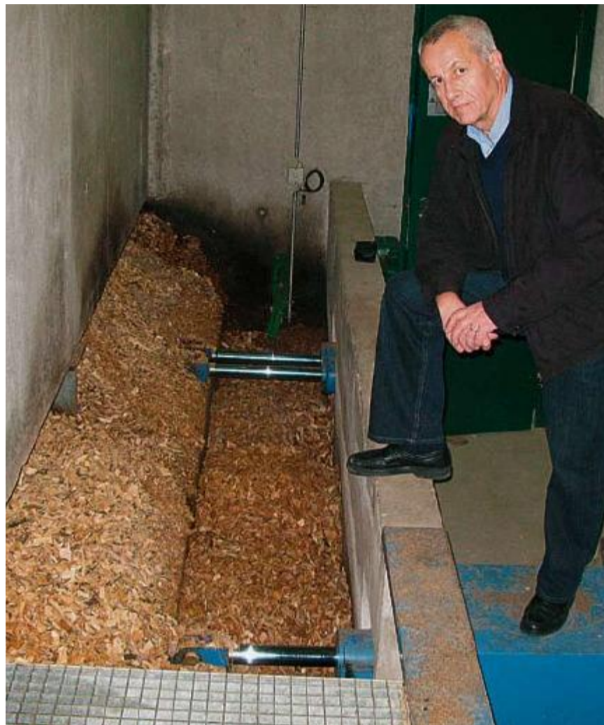
Er hat von Anfang an an den Energieträger Holz geglaubt: der abtretende Verwaltungsratspräsident des Willisauer Wärmeverbundes, Emil Peyer. Foto zvg
